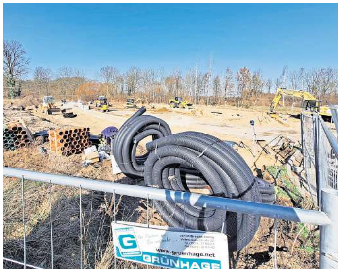
Noch sind die Bauarbeiten in vollem Gange, aber schon im Sommer will die Raiffeisen-Warengenosenschaft Osthannover am Schapers Kamp ihren neuen SB-Waschpark eröffnen.
